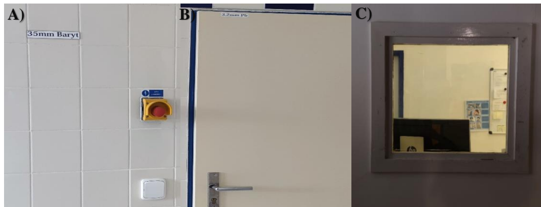
Obr. 4 Stavební ochranné opatření (A) Označení barytové omítky; B) Označení olovnatých plátů na dveřích; C) Olovnaté sklo)
