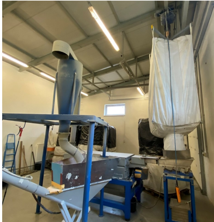
Obrázek 9 Násypka do šnekového potrubního dopravníku (zdroj: vlastní)
