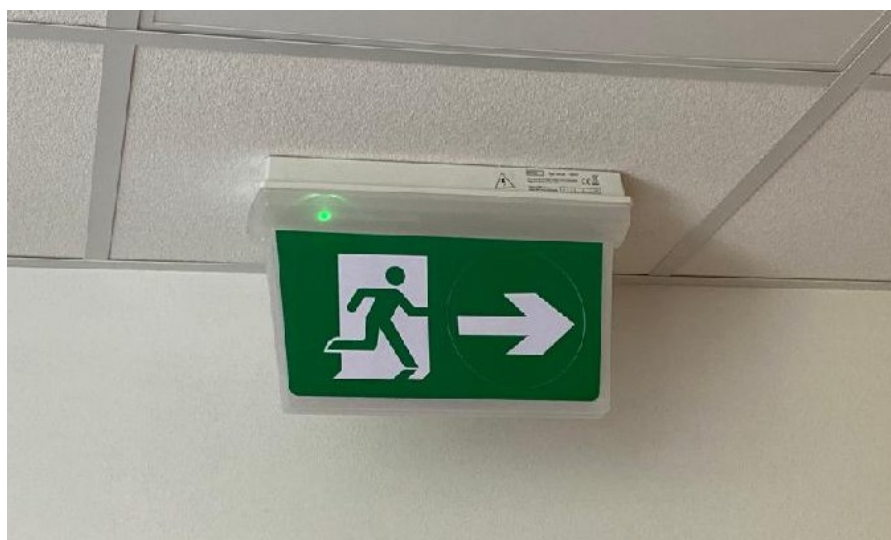
Obrázek 15 Značení únikových cest pomocí nouzového osvětlení (Vlastní zdroj, 2024).
