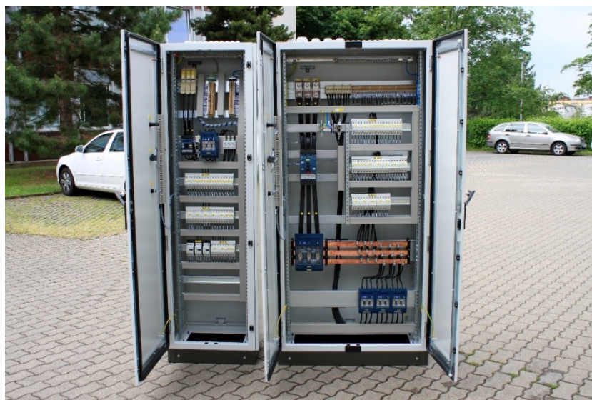
Obrázek 4: Rozvaděč (Martia a.s., 2024)
