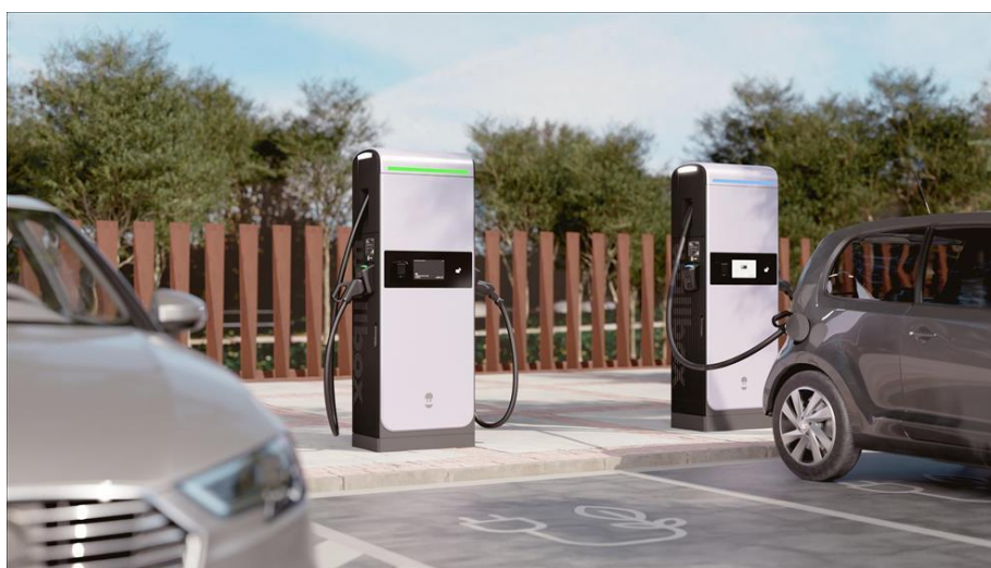
Obrázek 11: Dobíjecí stanice (Zdroj: Chytré nabíjení)
