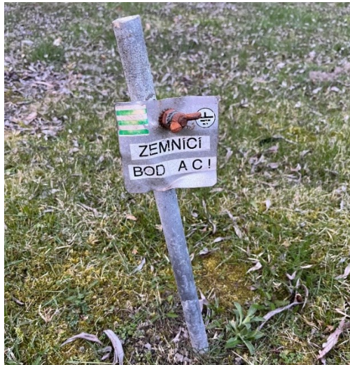
Obrázek 11 - Příklad označeného zemničího místa pro automobilové cisterny
