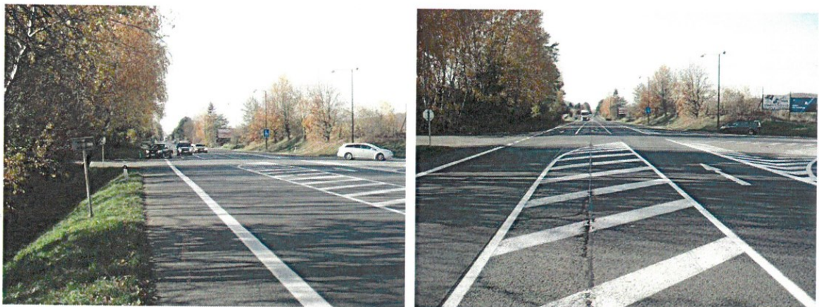
Obrázek 14 Absence levého odbočovacího pruhu (zdroj bezpečnostní inspekce, 2019)
