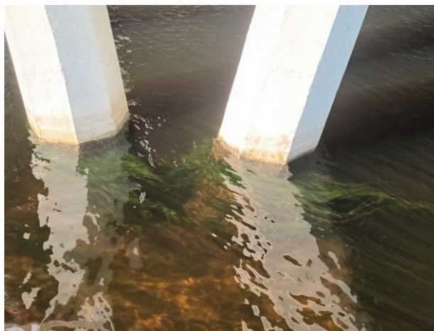
Obrázek 14. Řasy přichycené na patce betonového sloupu chladící věže
