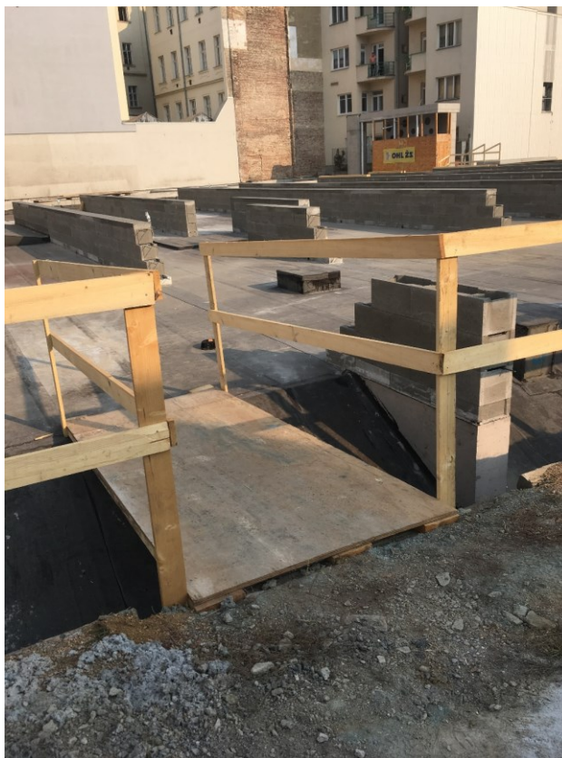
Obrázek 15 Prvky kolektivní ochrany (Zdroj: interní dokumentace společnosti) Úraz elektrickým proudem.
