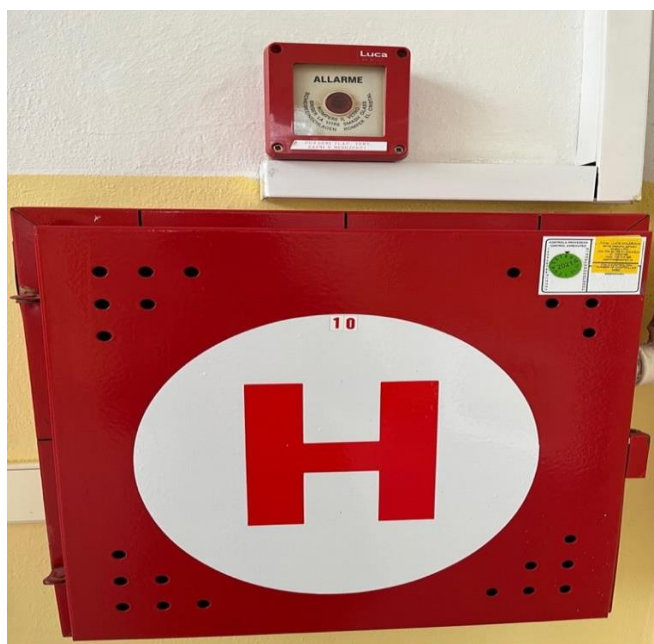
Obrázek 5 – Požární tlačítko a hydrant (Zdroj: vlastní)
