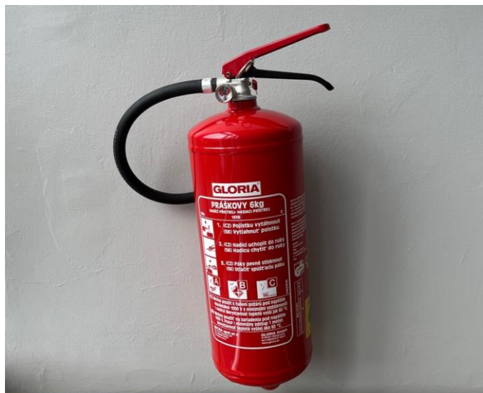
Obrázek 4 – Hasící přístroj II (Zdroj: vlastní)
