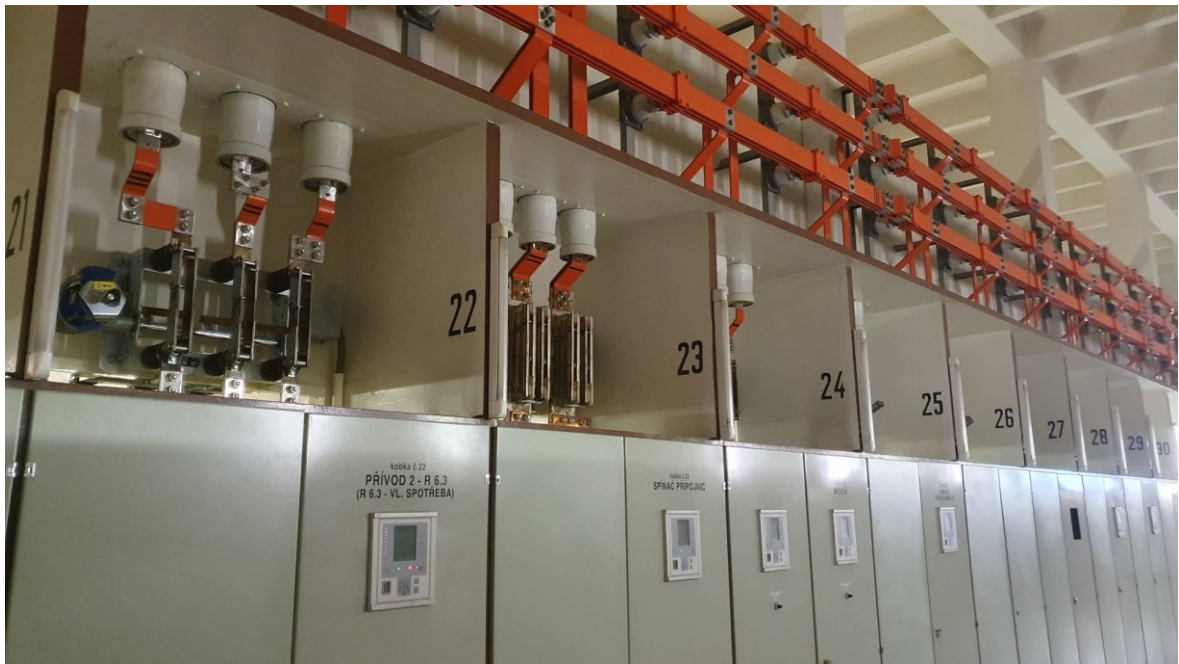
Obrázek 7 - Kobková rozvodna v budově Teplárny Zlín (zdroj vlastní)
