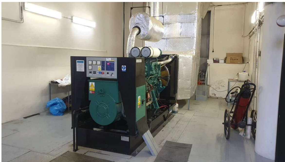
Obrázek 8 - Záložní diesel agregát Leroy Somer (zdroj vlastní, 2023)
