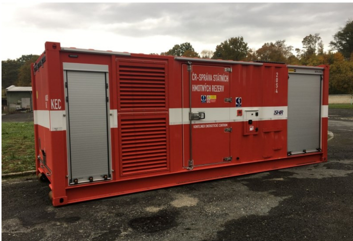
Obrázek 9 - Elektrocentrála SSHR o výkonu 200 kVA (KEC 200 - kontejnerová elektrocentrála, b.r.)
