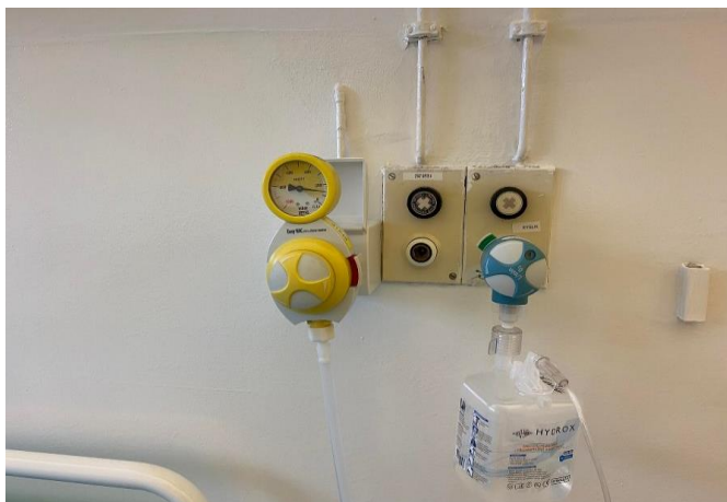
Obrázek 16 Zdroj aktivního sání za pomoci centrálně vedeného vzduchu. Nastaveno na sílu podtlaku -20 \text{ H}_2\text{O} (vlastní zdroj).
