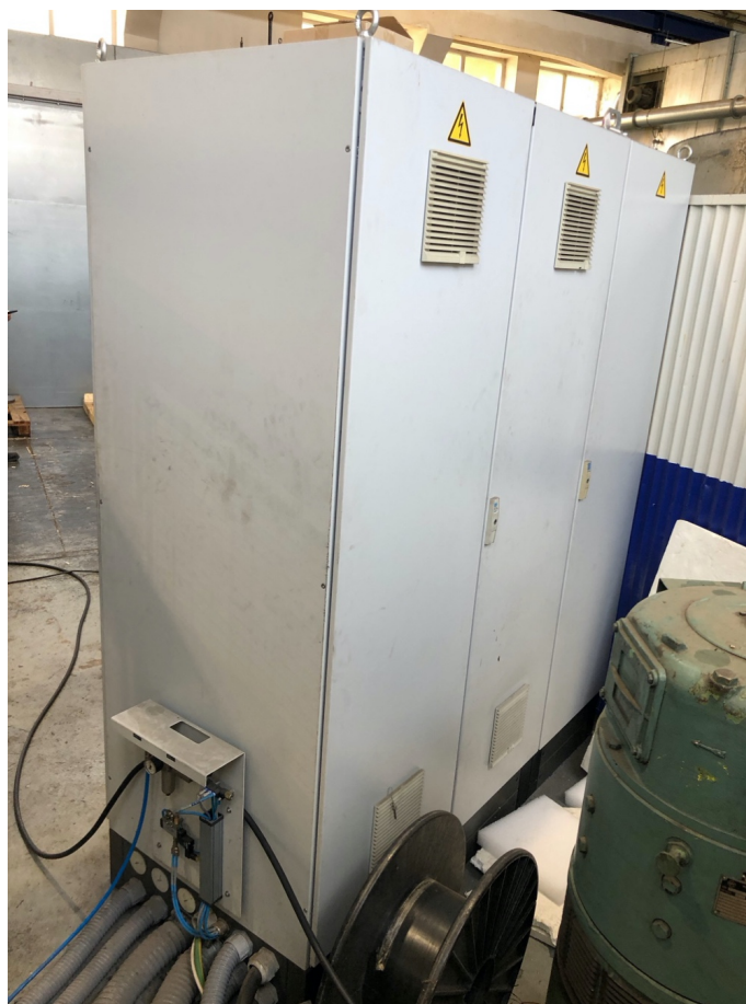
Obrázek 13 Zadní strana rozvaděče (vlastní zpracování)
