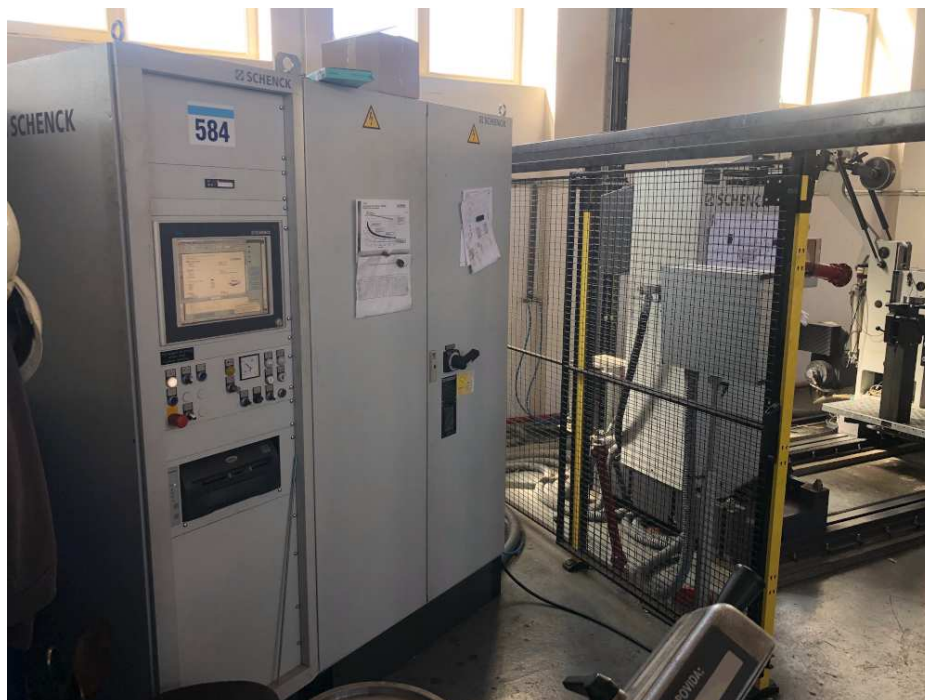
Obrázek 12 Čelní strana rozvaděče (vlastní zpracování)
