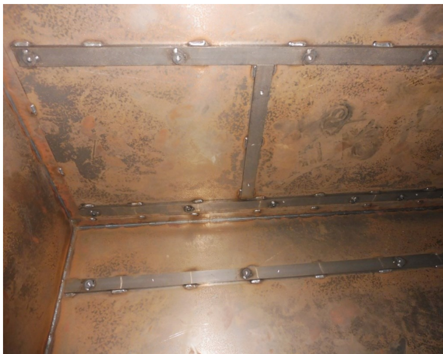
Obrázek 24 Celý vnitřek skříně zkorodován
