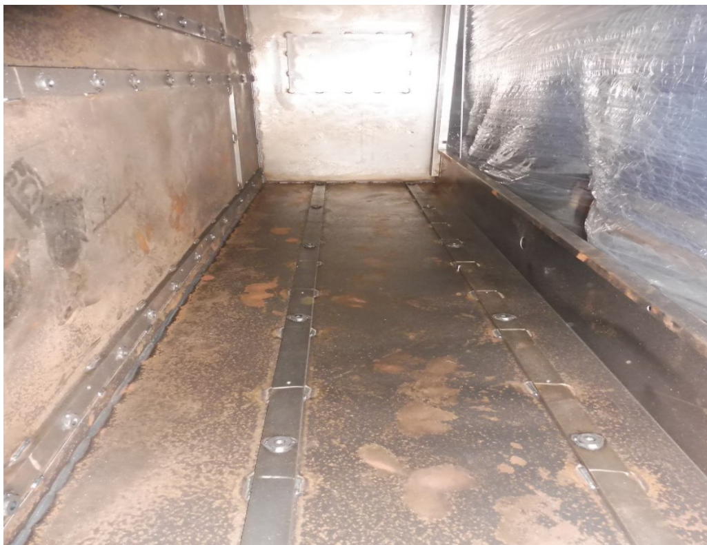
Obrázek 23 Zkorodovaná skříň uvnitř
