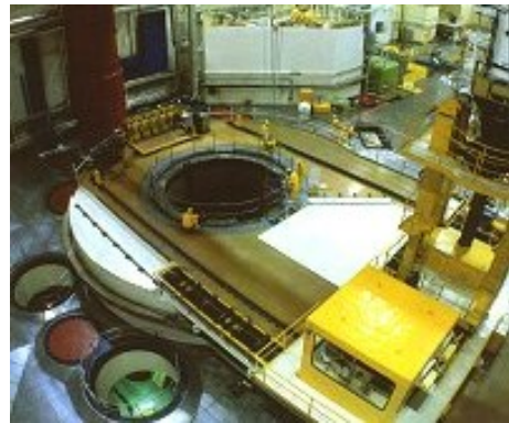
Obrázek 64. Reaktorová hala JE Dukovany. [Zdroj: O-64]
