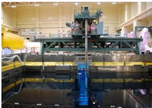
Foto 116. Vodní bazén pro skladování vyhořelého paliva v blocích elektrárny Fukušima I. [Zdroj: F-116]
