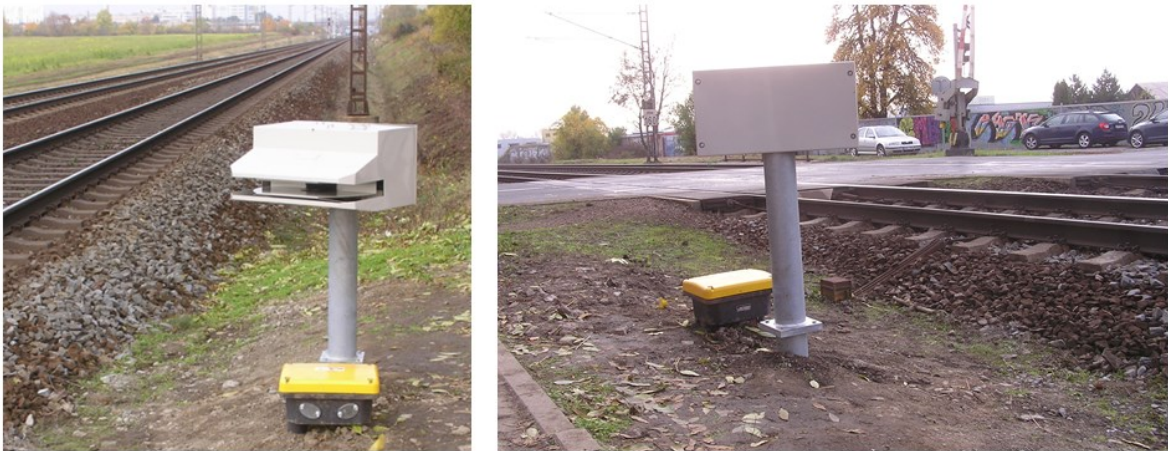
Obr. 24. Pohled na umístění detektoru na železničním přejezdu v Olomouci
