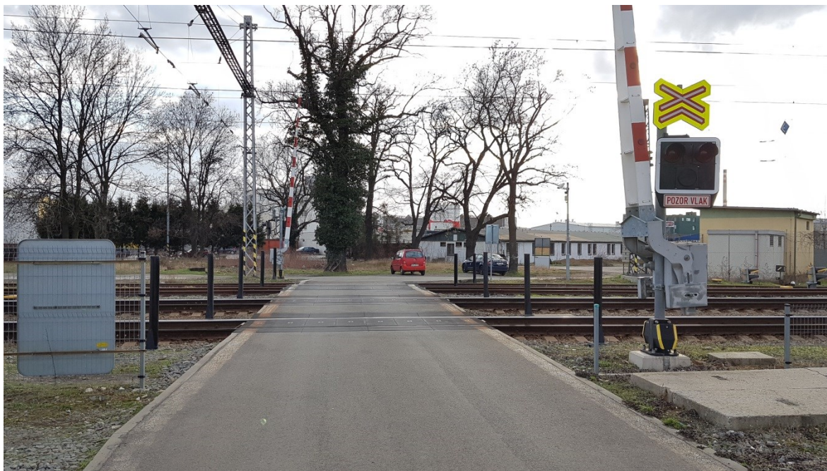
Obr. 27. Umístění infrazávor na železničním přejezdu
