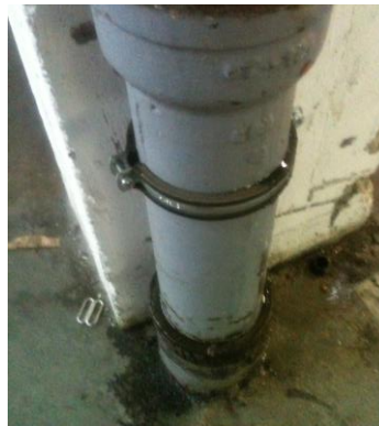
Obr. 37 Špatná izolace odtoku ze střechy (vlastní zpracování)
