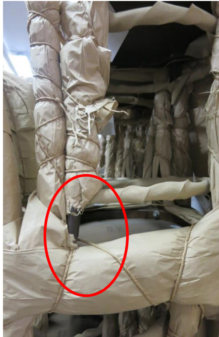
Obr. 27 Poškozené smotky (vlastní zpracování)
