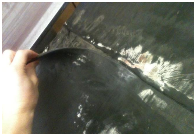
Obr. 14 Zanedbaný a poškozený pás (vlastní zpracování)
