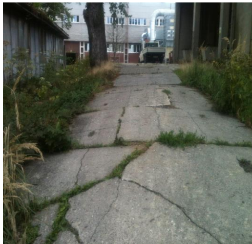
Obr. 23 Špatně udržovaná pozemní komunikace (vlastní zpracování)
