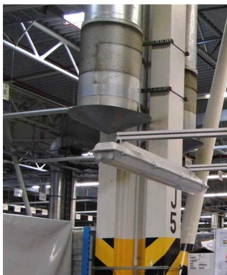
Obr. 21 Zařízení k výměně vzduchu
