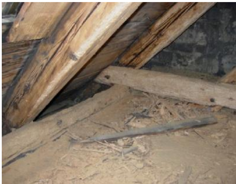
Obr. 12 Ukázka napadené konstrukce
