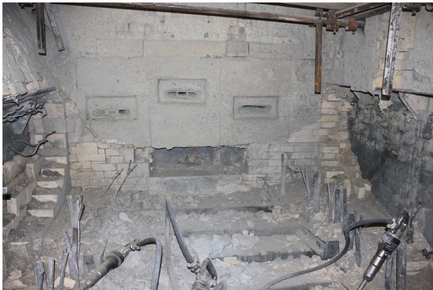
Obr. 53 Vybúranie výmurovky chladiča (Vlastné spracovanie)
