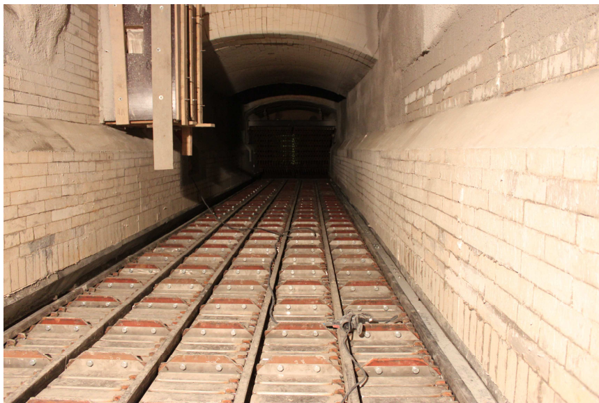
Obr. 57 Uvedenie do prevádzky chladiča (Vlastné spracovanie)
