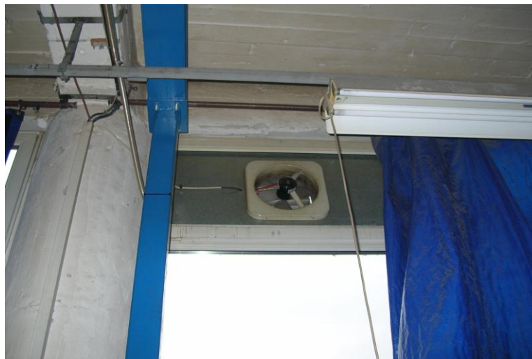
Obr. 14. Odsávání na pracovišti II
