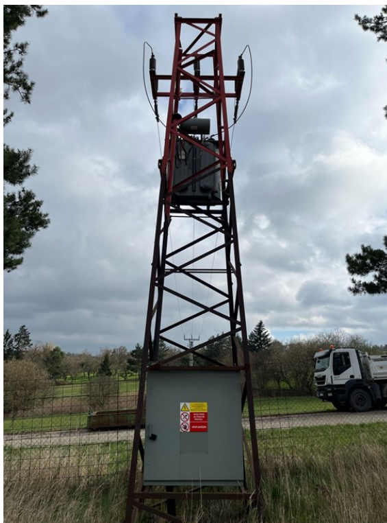
Obrázek 9 Rozvodna elektrické energie (vlastní)
