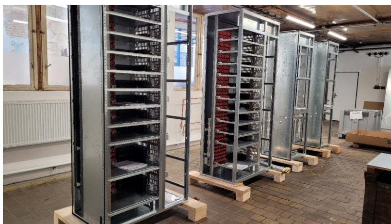
Obrázek 5 Rozvaděčové skříně (interní materiály firmy)
