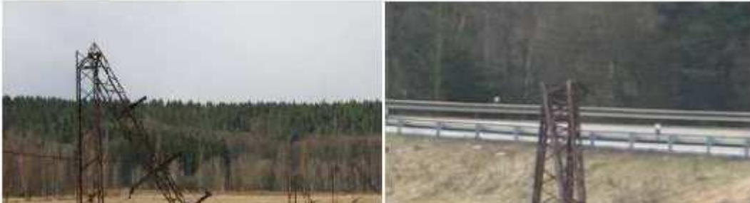
Obr. 5 Ukážka miesta lomu konštrukcie oceľového stožiaru
