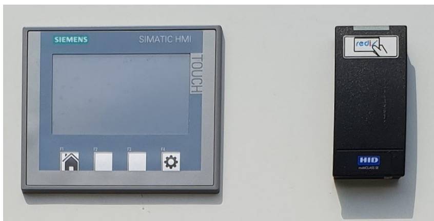
Obr. 8.42 Pohled na čtečku RFID vedle touch panelu [24]
