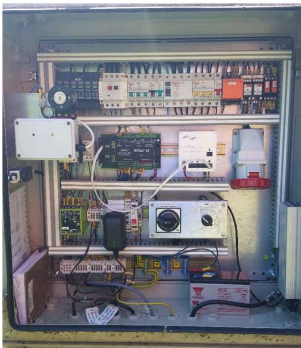
Obr. 7.2 Pohled do otevřeného rozváděče ČSOV (jedno čerpadlo) [10]
