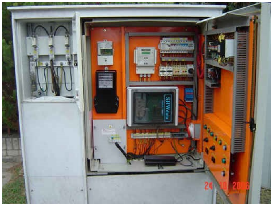
Obr. 8.2 Pohled na reléové vybavení ČSOV vč. rovodnice s výzbrojí pro telemetrii SHW data [10]
