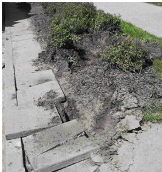
Obr. 28 Zničené dláždění vedle vozovky
