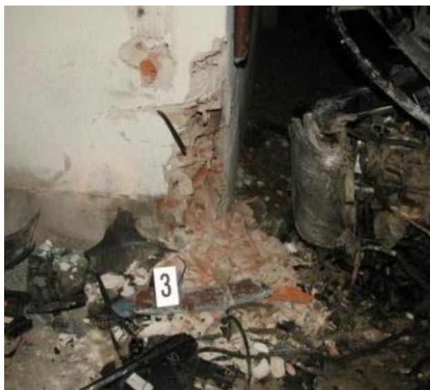
Obr. 27 Poškození rohu budovy
