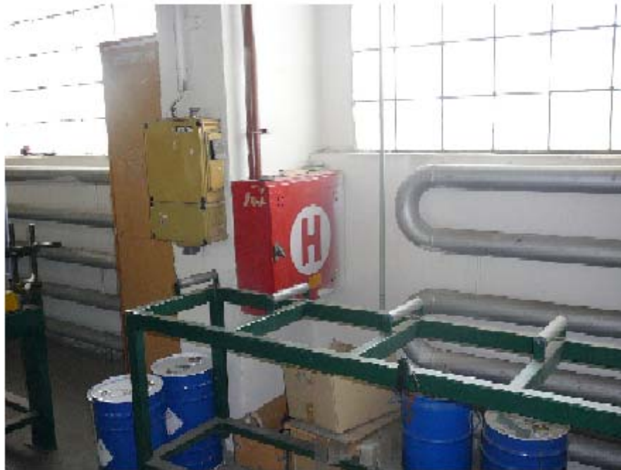
Obr. 20 Špatný přístup k hydrantům, Zdroj: Vlastní zpracování
