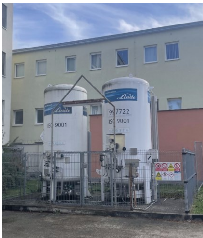
Obrázek 16 Tlakové nádrže na kyslík před vchodem do sekce B2
