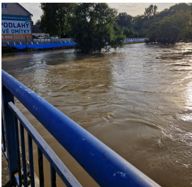
Obrázek 10 Chomoutov – protipovodňové hrazení
