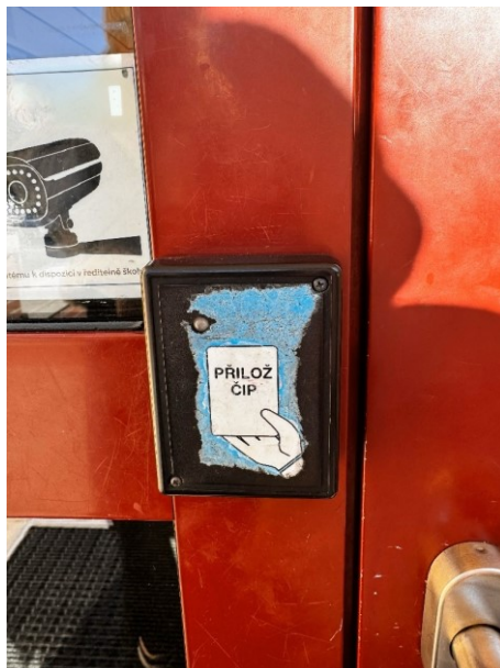
Obrázek 3 Detail čtečky čipů pro vstup do budovy
