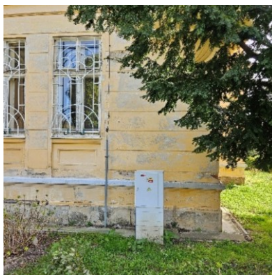
Obrázek 16 Sloupek přívodu el. proudu do budovy s nožovými pojistkami
