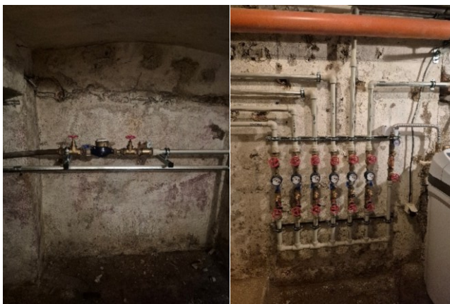
Obrázek 15 Hlavní uzávěr vody s vodoměrem ve sklepě (vlevo), podružné uzávěry vody s vodoměry ve sklepě (vpravo)
