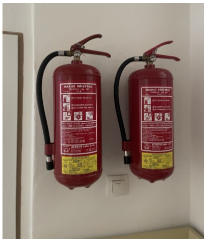
Obrázek 14 hasící přístroje v budově.
