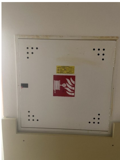
Obrázek 15 Nástěnný hydrant v budově školy.
