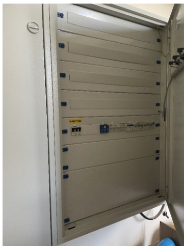
Obrázek 8 Hlavní jistič elektrického proudu.
