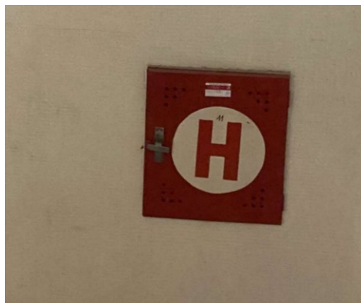
Fotografie 6 Požární hydrant
