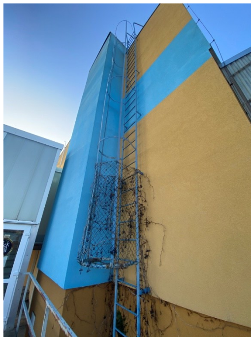
Obrázek 14 – Žebřík zabezpečený bezpečnostními dvířky a pletivem
