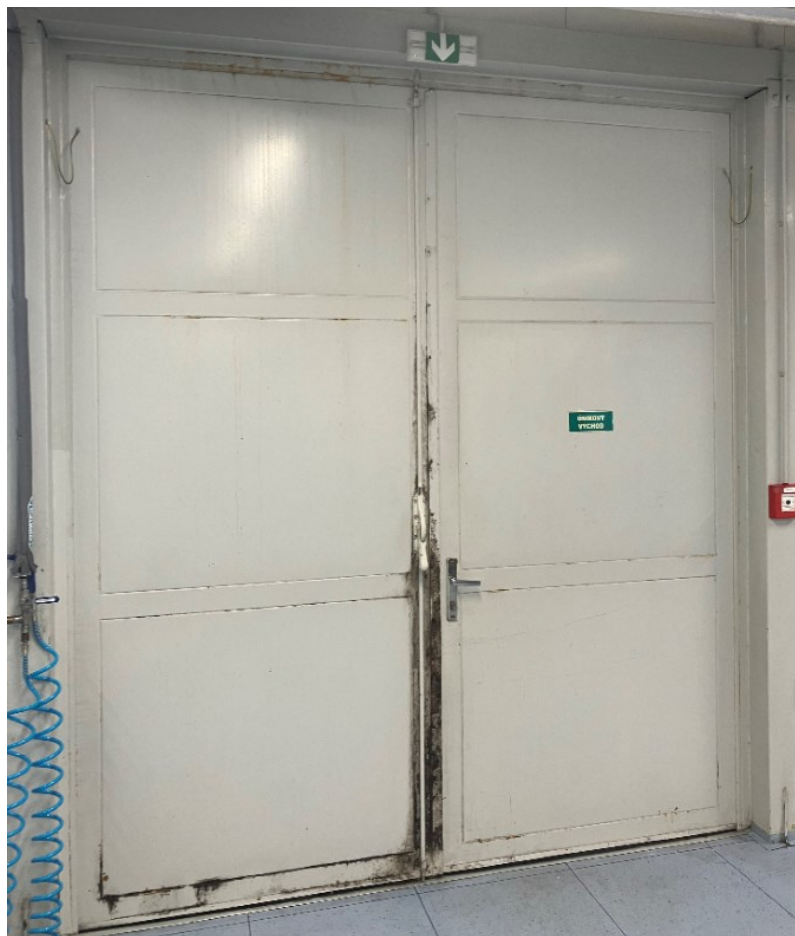
Obrázek 15 Vstupní dveře bez automatického zavírání (zdroj: vlastní)
