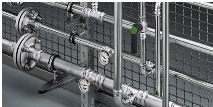
Obrázek 6 Potrubí z korozivzdorné vysokolegované oceli [9]
