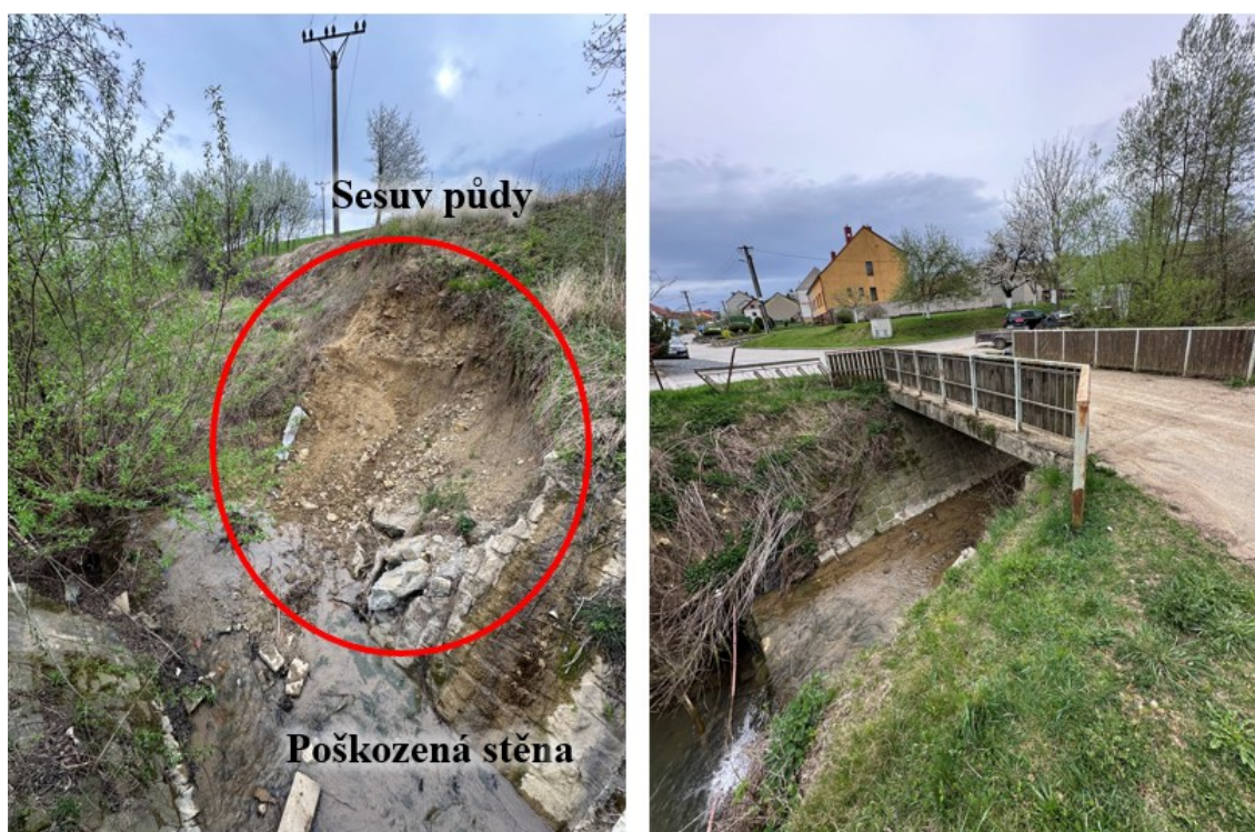
Obrázek 90 – Sesuv půdy a poškozená stěna [vlastní]
