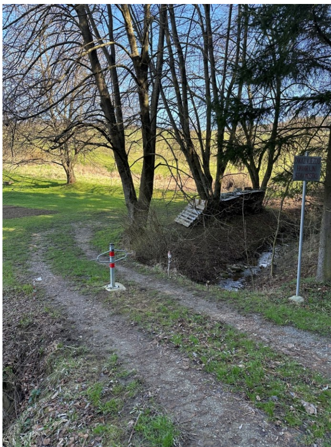
Obrázek 80 – Havarijní stav mostku [vlastní]
