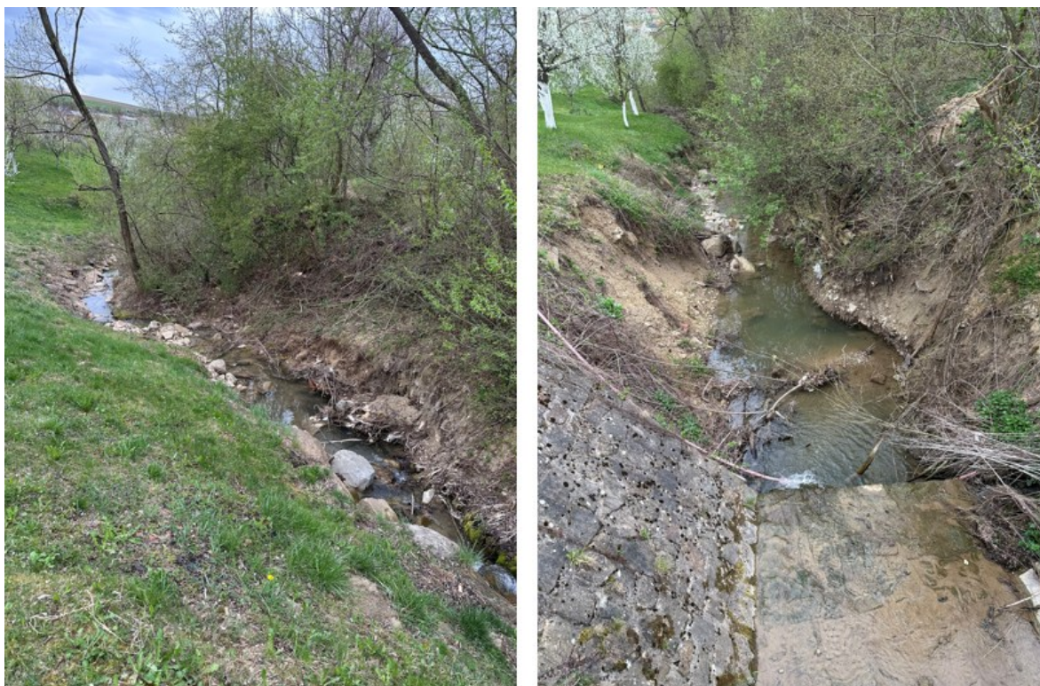
Obrázek 91 – Aktuální stav koryta pravostranného přítoku na hranici intravilánu ulice Dolina [vlastní]
