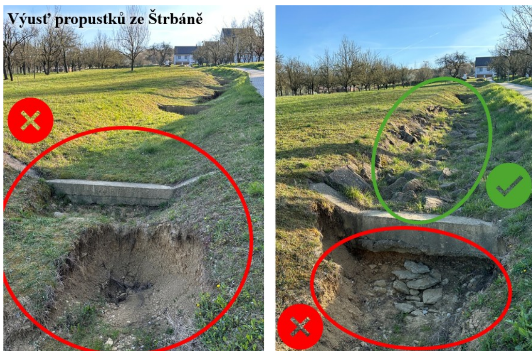
Obrázek 69 – Ukázka nedostatečné realizace prahů a dopadiště [vlastní]
