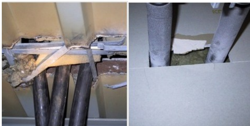
Obrázek 10 Nesprávné provedení ucpávek v šachtách
