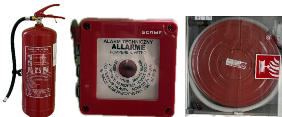
Obrázek 10 Hasicí přístroj, tísňové tlačítko a nástěnný hydrant
