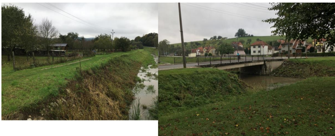
Obrázek 15 Ukázka obou hlavních nedostatků v protipovodňové ochraně Vrbětic [85]
