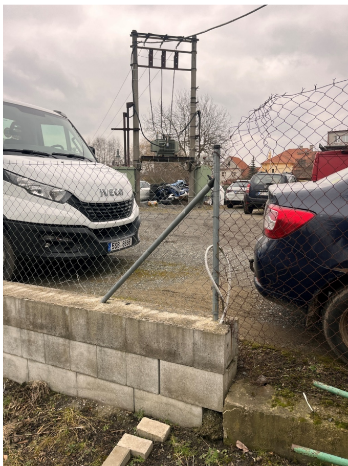
Obrázek 8 Nevyhovující stav plotu na hranici s autoservisem
