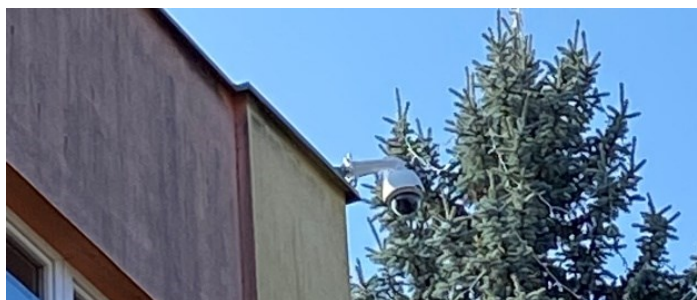
Obrázek 17 Umístění kamer na budově (vlastní)
