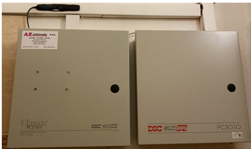
Obrázek 18 Zabezpečovací ústředna (vlastní)
