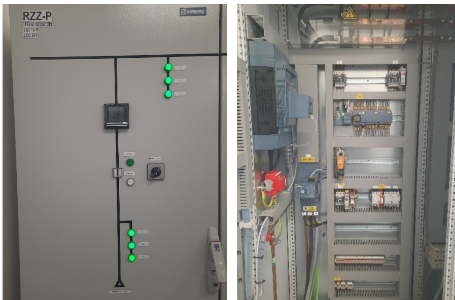
Obrázek 33 - Ukázka signalizace, ovládacích prvků (vlevo) a vnitřku (vpravo) RZZ
