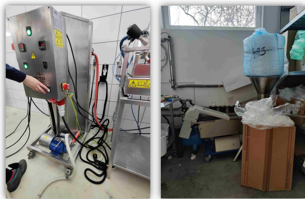
Obrázek 45 Kabely, hadice a zbytečné překážky (vlastní zpracování, 2024)
