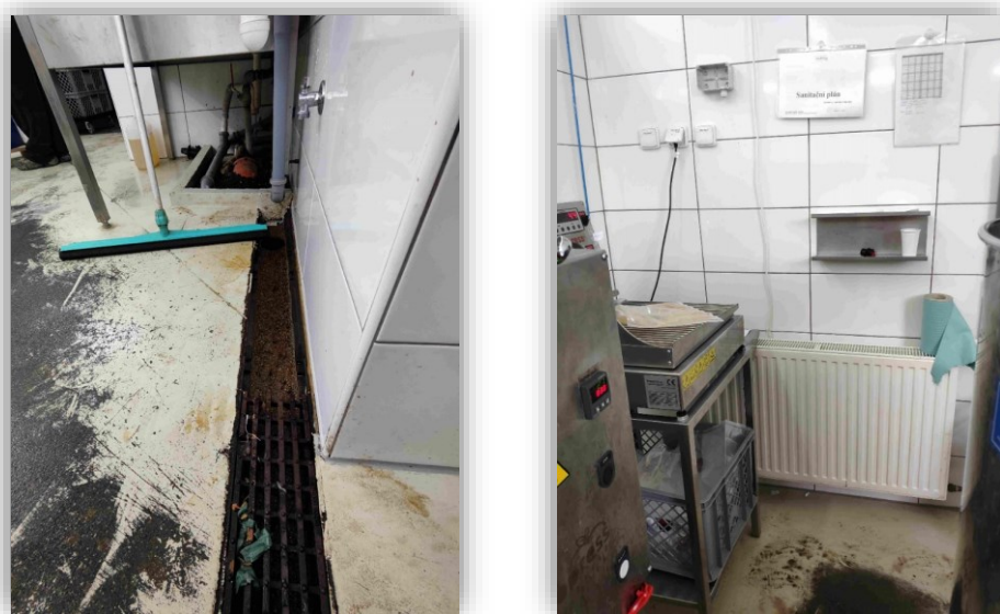
Obrázek 46 Odtokový kanálek a nedostatečný prostor pro zajištění čistoty při pasterování (vlastní zpracování, 2024)
