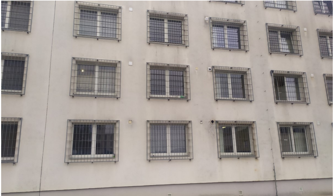
Obrázek 1 – Stavebně technické zabezpečení oken. (Vlastní, 2024)
