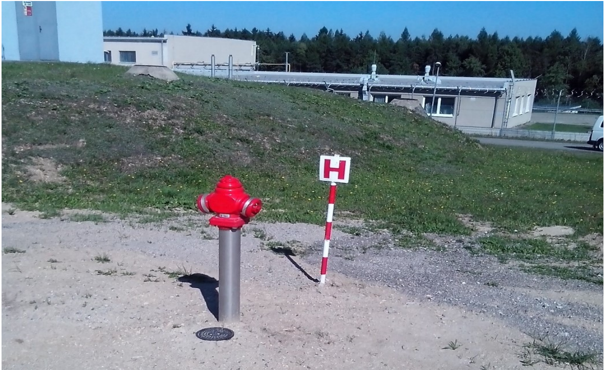
Obrázek 6 – Nadzemní hydrant ve Věznici Rapotice. (Vlastní, 2023)
