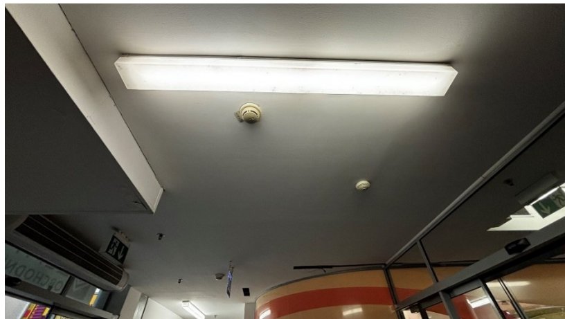
Obr. 17. Prvky požární ochrany u vstupu č. 3 [vlastní]
