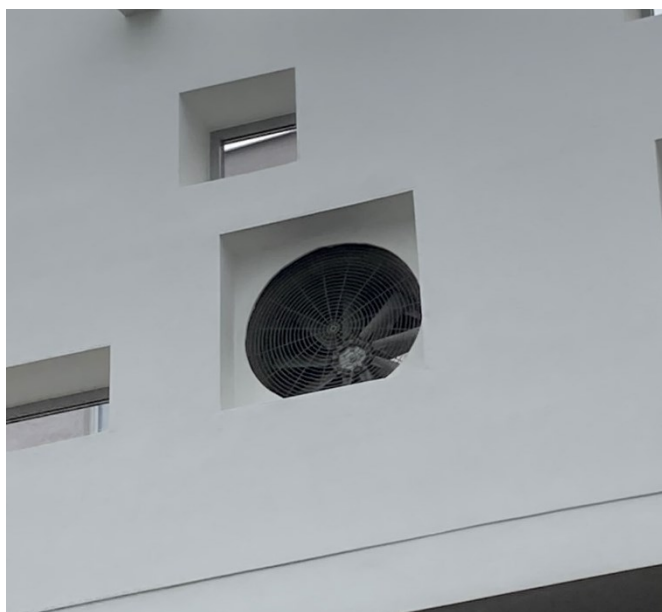
Obr. 24. Vzduchotechnika ve 2. patře [vlastní]
