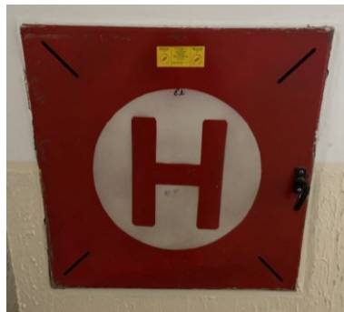
Obrázek 5 – Vnitřní nástěnný hydrant
