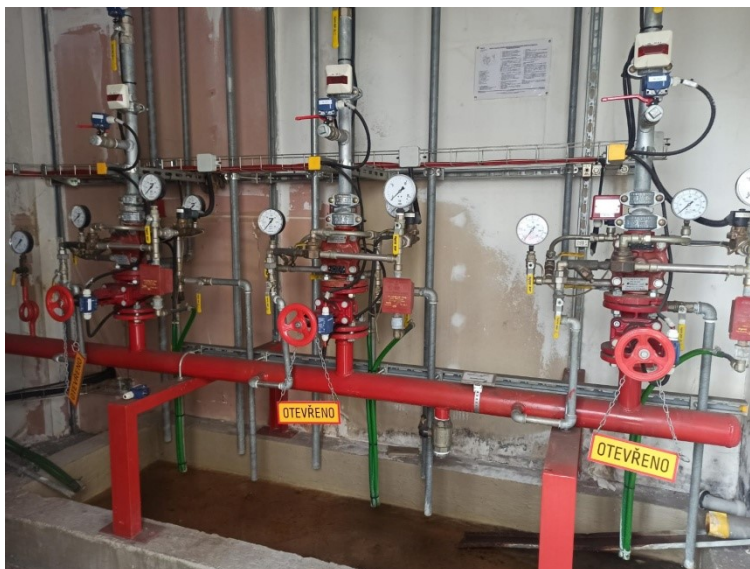
Obrázek 7 Ventilová stanice dieslového agregátu pro vodní clony (vlastní)
