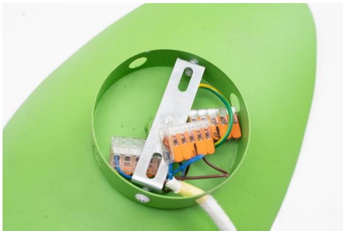
Obrázek 50: elektroinstalace vodičů v krytce světla
