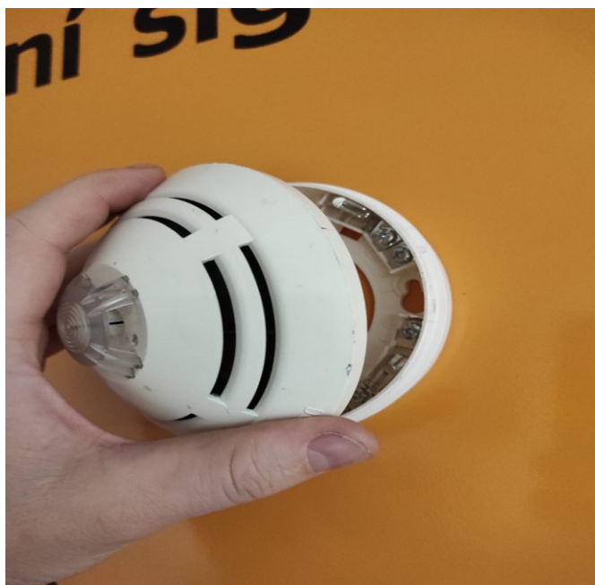
Obrázek 19: Demonstrace vyvolání poruchy hlásiče (foto autor)
