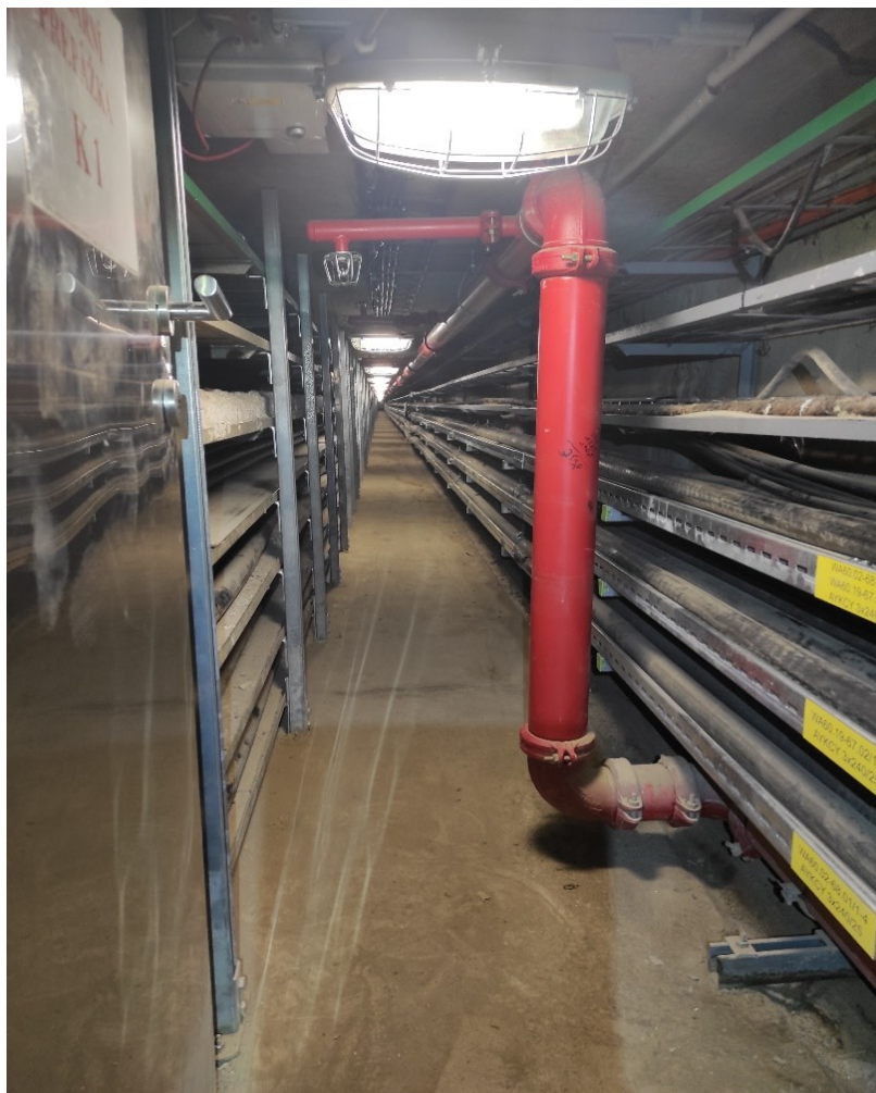
Obrázek 12: Sprinklerové vedení u K1 (foto autor)
